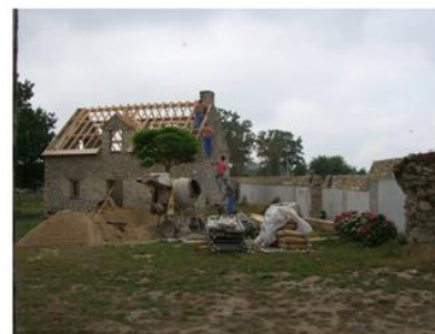
La maison avant travaux, avec sa charpente neuve reprenant le volume initial. © DR
